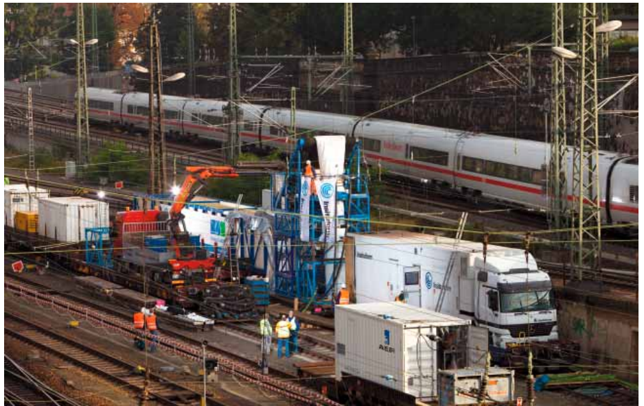
Die große Flexibilität des Insituform-Verfahrens, sich den unterschiedlichsten Sanierungsaufgaben und deren Randbedingungen anzupassen ist einer der wesentlichen Gründe für den Erfolg.
