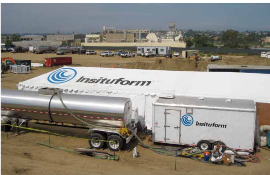
Baustelleneinrichtung auf dem Flughafen San Diego in Kalifornien: Hier wurde unter der Landebahn in 6 Metern Tiefe ein mit Karbonfasern verstärkter Schlauchliner DN 2500 mit einer Länge von 427 Metern eingebaut.
